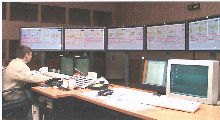
Центр диспетчерского управления устройствами энергоснабжения
