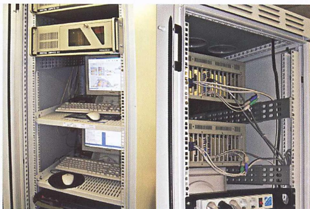
Оборудование ДЦ «ЮГ»
