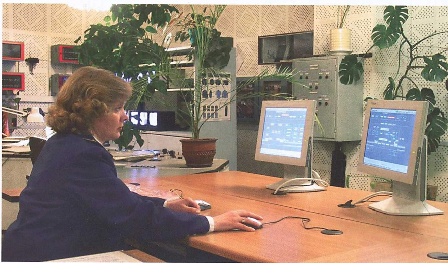
АРМ дежурного по станции, оборудованной КАСДУ
