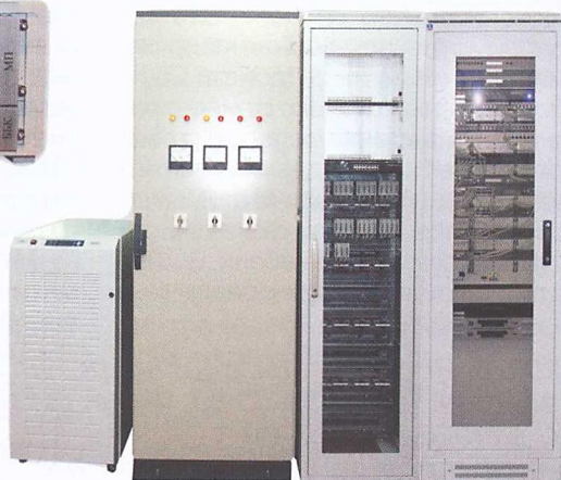
Постовое оборудование МПЦ-И
