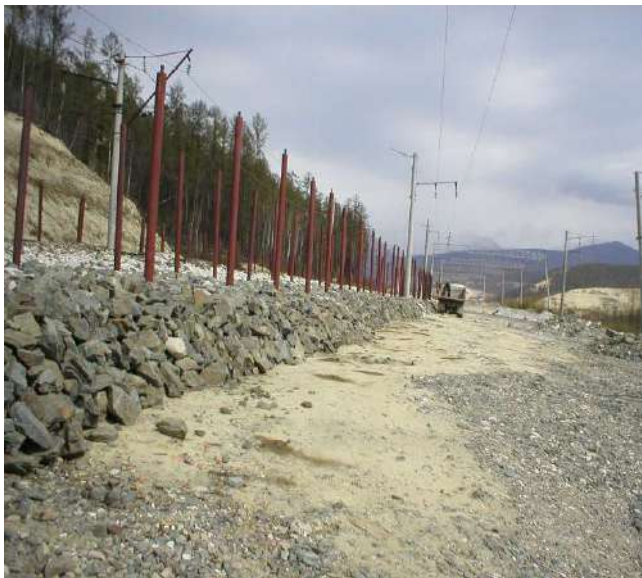
Рисунок 4 – Состояние главного пути на ст. Казанкан. Все СОУ после устройства находятся в одном уровне, их высота составляет около 3 м, октябрь 2003 г.
