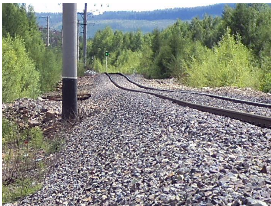
Рис. 1. Деформации земляного полотна из-за протаивания льдистых грунтов основания
