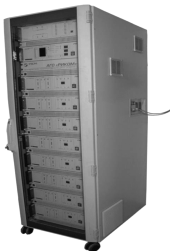
Рис. 14.1. Стойка местной усилительной станции «РИКОМ»-06
