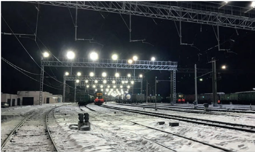
Объект, оснащенный светодиодными светильниками
