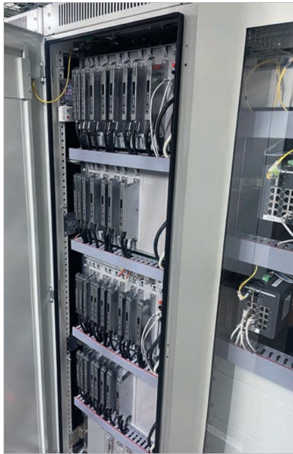
Шкаф объектных контроллеров
