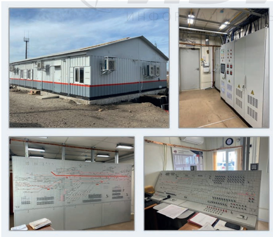
Пример восстановления устройств электрической централизации железнодорожной станции
