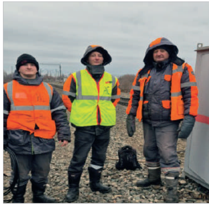
Электромеханики М.Е. Муравьев, М.А. Кривошеев, В.В. Клынин во время прокладки кабеля связи для ПСЧ
