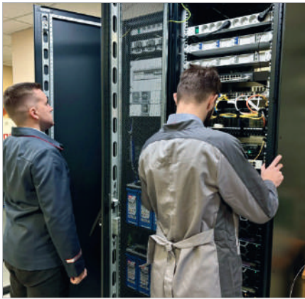
Старший электромеханик А.И. Баев и электромеханик А.Д. Полищук выполняют ГТП на оборудовании LTE
