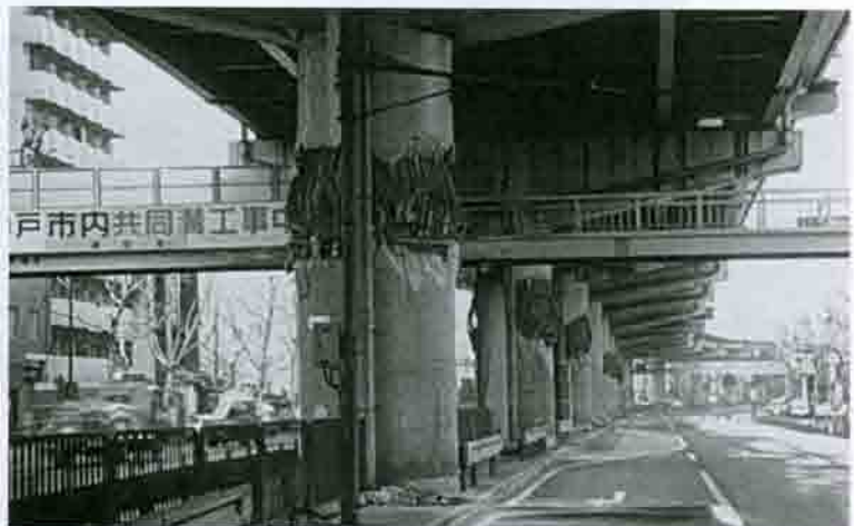
Рис. 17.21. Повреждение опор виадука высокоскоростной железнодорожной линии «Санъё» при землетрясении в Кобе. Япония, 17 января 1995 г.
