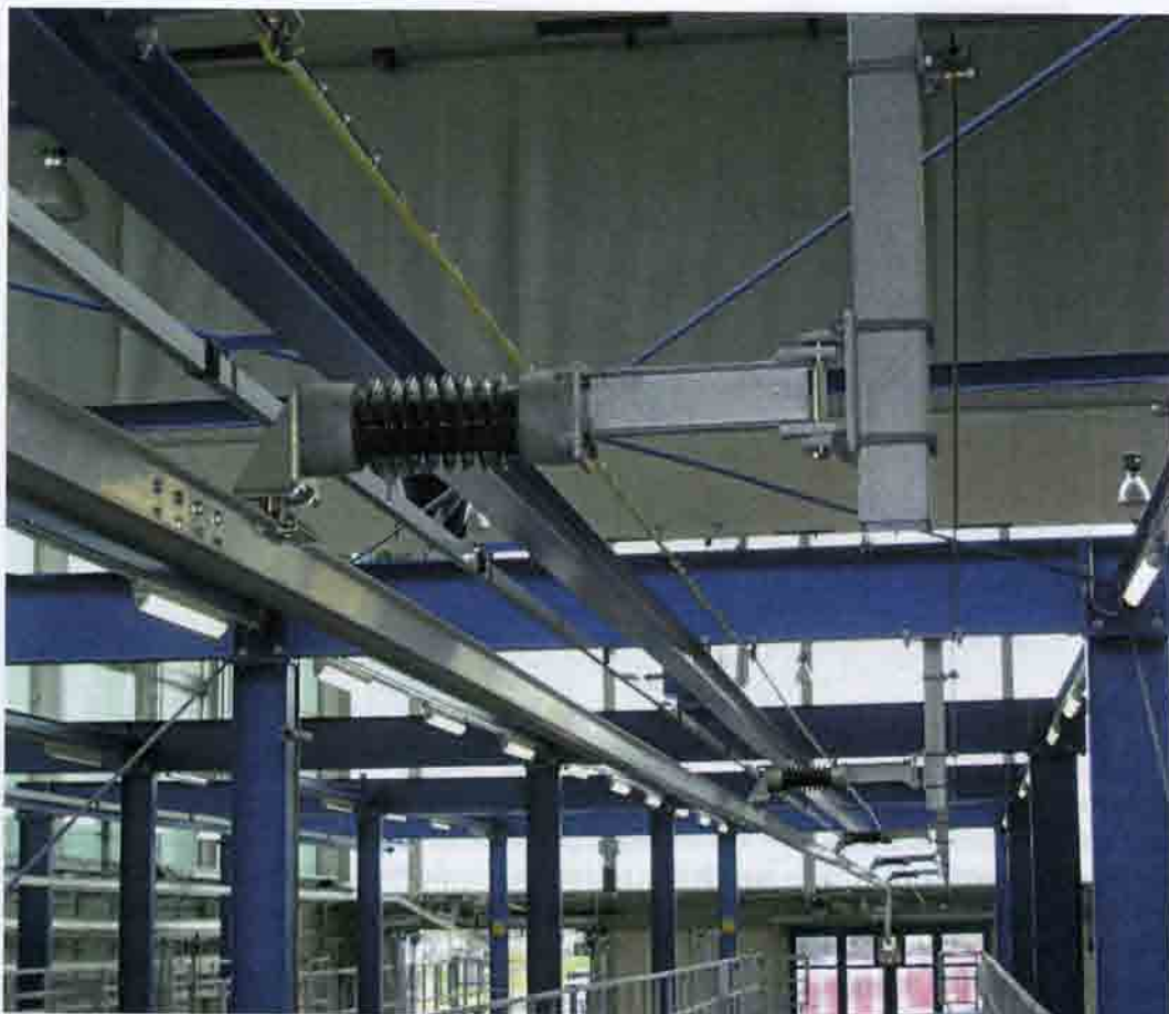
Рис. 21.17. Участок подвижной контактной подвески с убирающимся проводом в цехе депо
