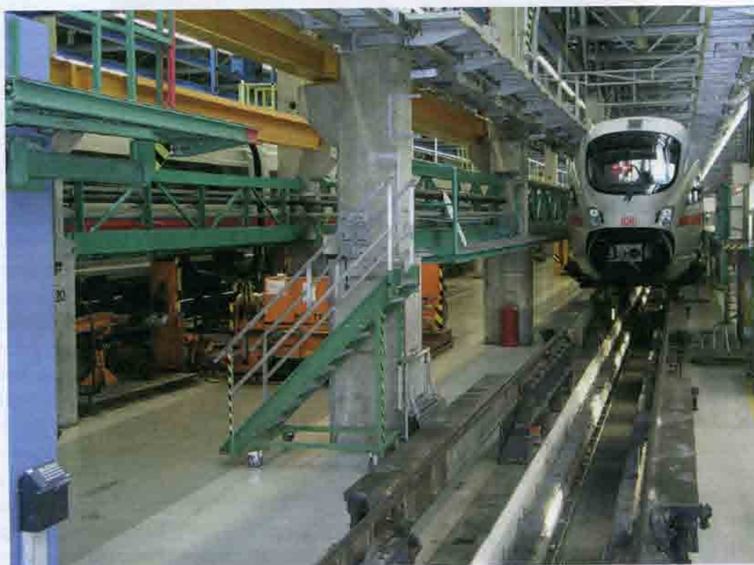
Рис. 21.5. Смотровая канава и смотровые площадки на разных уровнях в депо высокоскоростных поездов Мюнхена, Германия. 2008 г.
