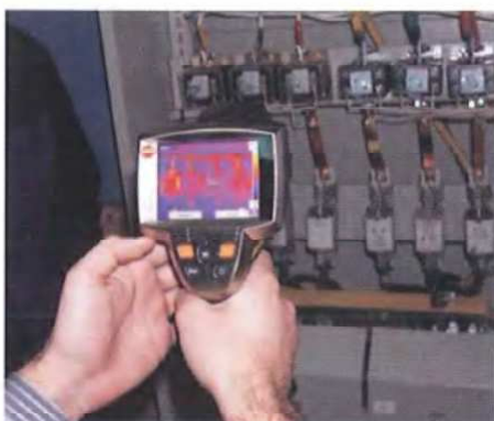
Термографическое обследование электроустановок
