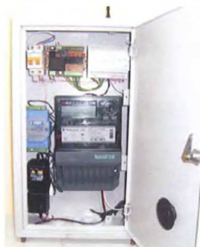
Узел учета электрической энергии
