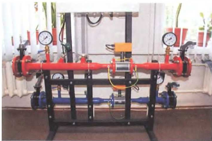
Узел учета горячего и холодного водоснабжения
