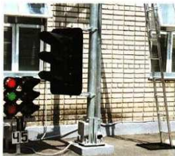
Светофоры, мачты которых выполнены методом горячего цинкования
