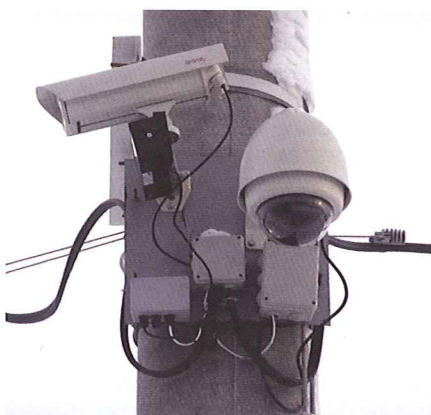
Поворотная видеокамера на специальном объекте
