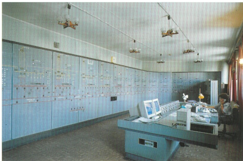
Диспетчерский пункт электроснабжения на Московско-Петроградской линии. 1995
