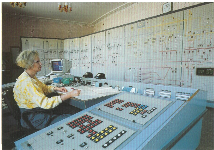
Диспетчерский пункт электроснабжения на Кировско-Выборгской линии. 1995
