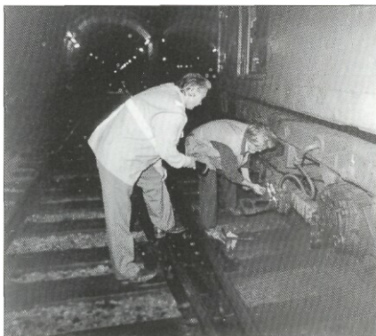
Проверка технического состояния электропоезда. 1991. Фотограф неизвестен
