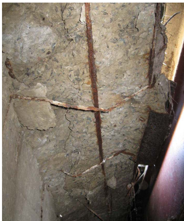
Рис. 8 - Оголення та корозія арматури фундаментної частини вагонних ваг
