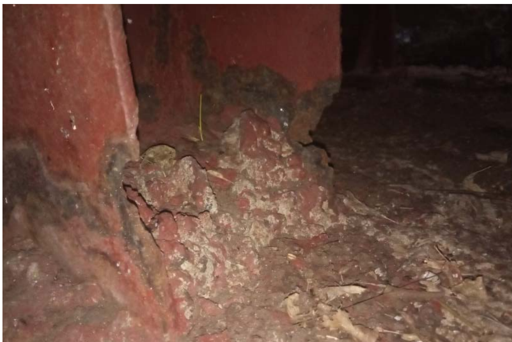
Рис.3 - Корозійне пошкодження опорних елементів вагонних ваг
