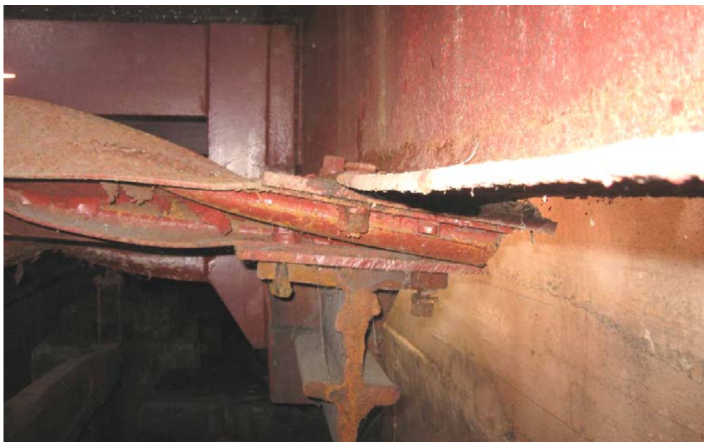
Рис. 6 - Пошкодження поперечної опорної балки платформи ваг внаслідок її падіння
