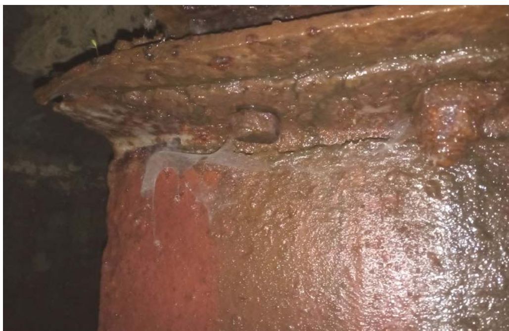
Рис. 4 - Тріщина у швелері поперечної опорної балки
