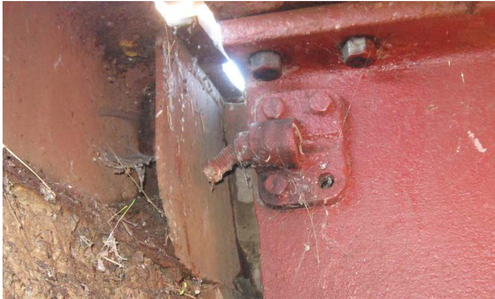
Рис. 5 - Деформація торцевого упора платформи вагонних ваг
