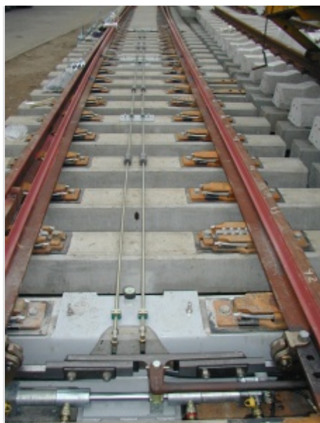
Система тяг и рычагов, заменённая гидравлическими шлангами
